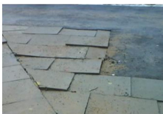
Uneven flagged Footway
